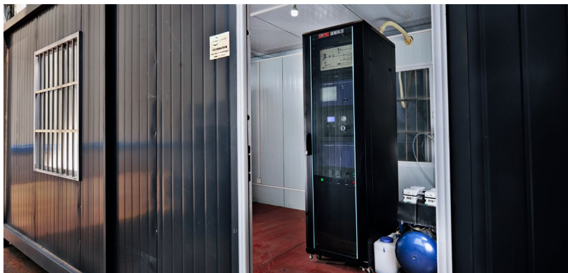
新增VOCs在线监控装置
