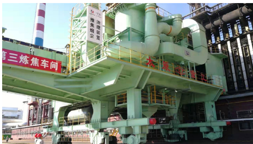
焦炉机械设备车载除尘技术运用
