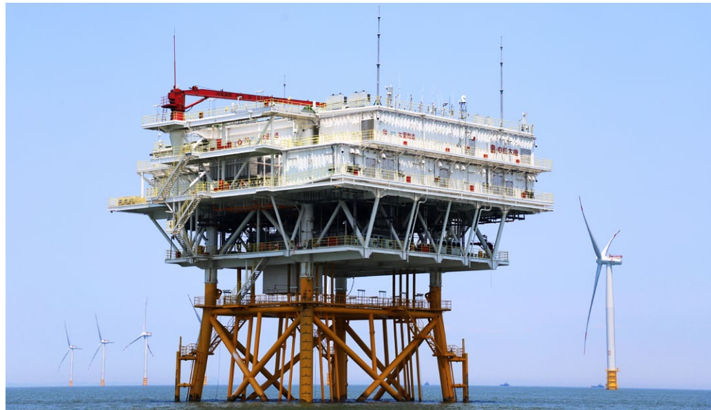
大型海上升压站装备，助力海上风电提供清洁电能
